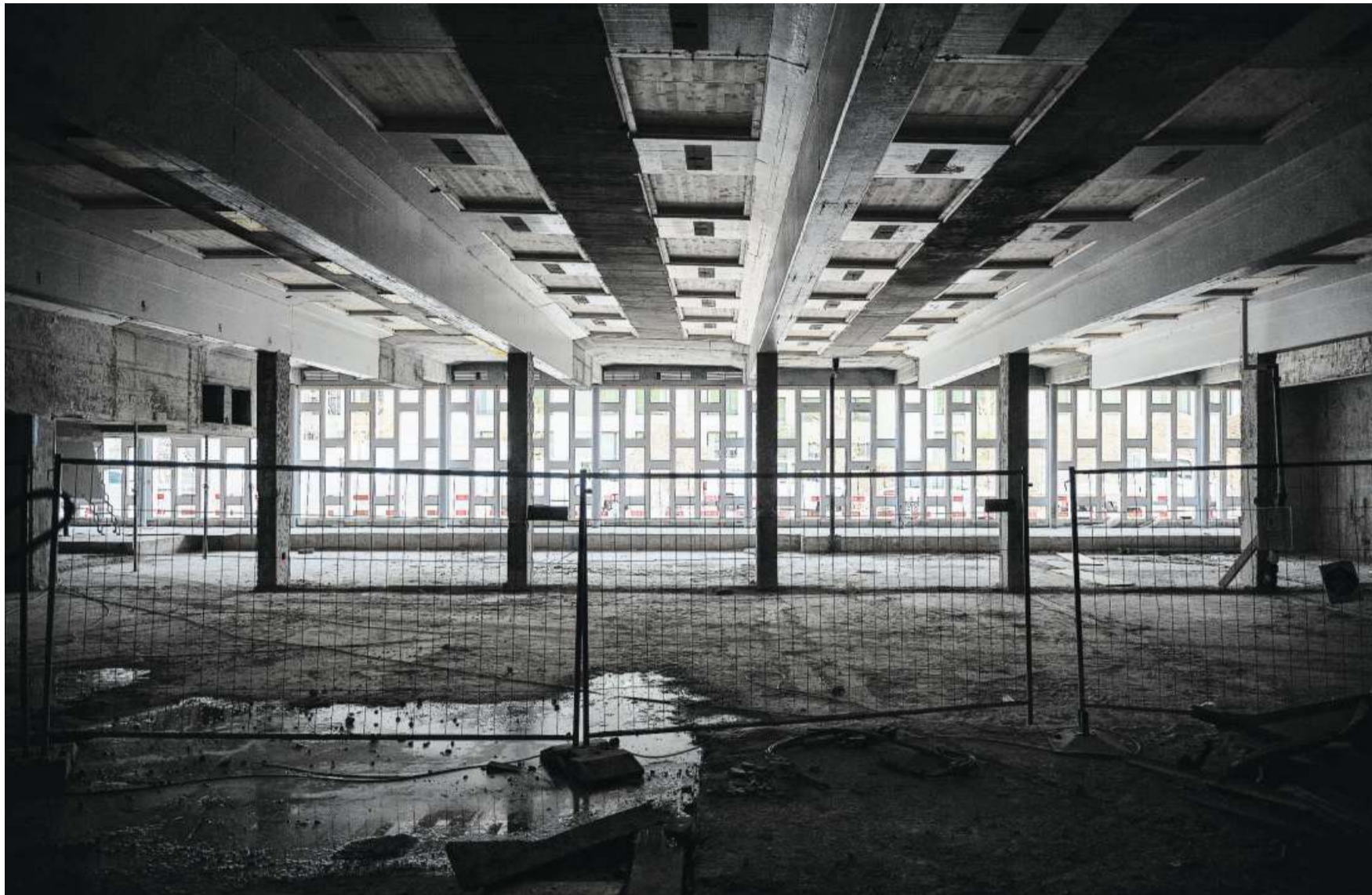
Im Bettenhaus des Felix-Platter-Spitals in Basel wird gleichzeitig Beton abgebrochen und neu gegossen.
